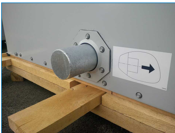
Nederste afblændede spiraltilslutning på fordampningskondensatorer.
