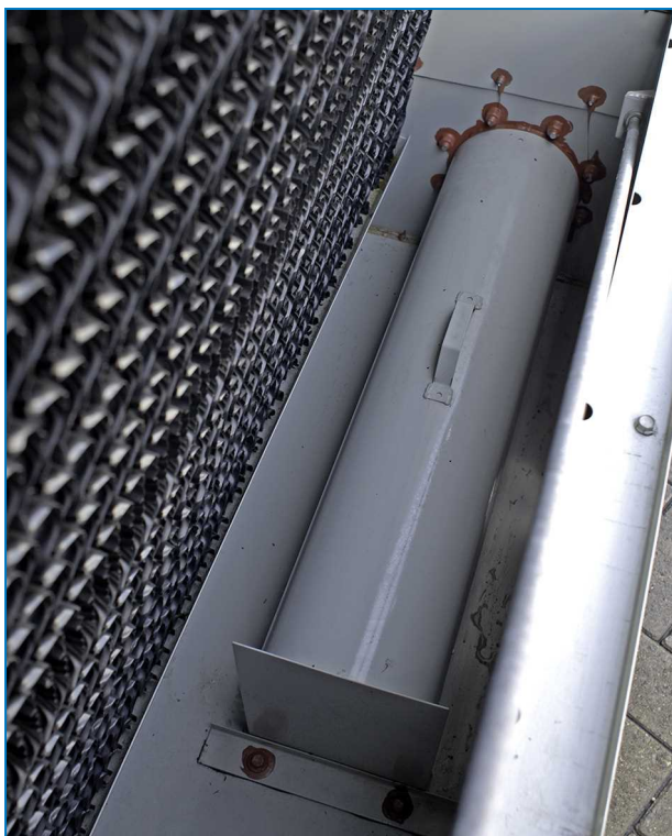
Nádrž na ochlazenou vodu a filtry nádrže
