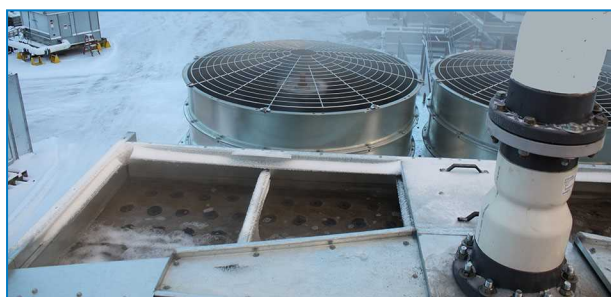
Бассейн горячей воды и опционные крышки распределительного поддона
