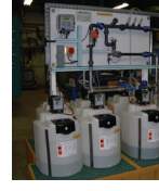
Su arıtma ekipmanı
