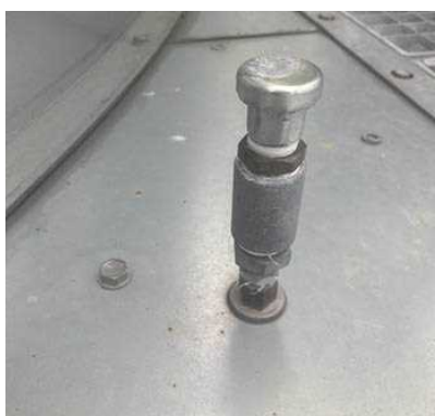
Levegőztetőnyílás a ventilátortetőn
