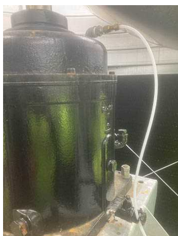
Levegőztetőnyílás a hajtóművön
