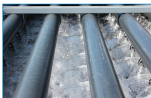
Sistema de pulverización presurizado
