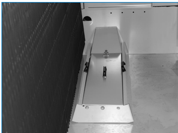
Misa wody zimnej i sito misy
