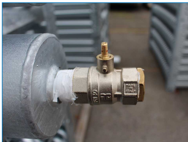
Horní připojení TVT s pojistným tlakovým ventilem na chladicích věžích s uzavřeným okruhem se spoji většími než ND100.
