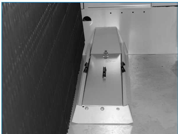
Balsa de agua fría y filtros de la balsa
