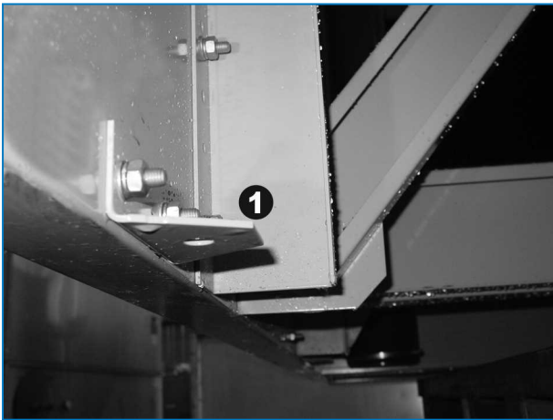
Vue intérieure de la section plenum
