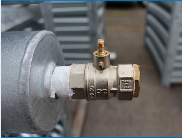
Övre slingkoppling med övertrycksventil på kondensorer.
