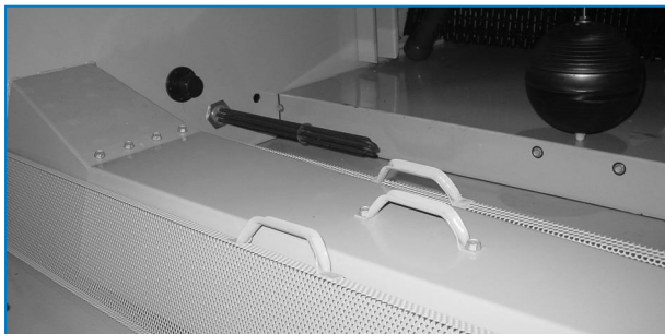
Koudwaterbekken en bekkenfilter
