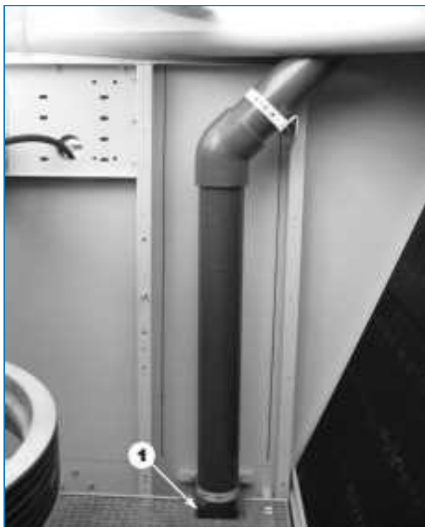
Rury pomp wewnątrz komory wyrównawczej
